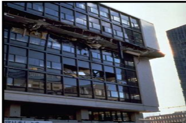
Figure II.30: Séisme de Kobe, 1995 – Document EQIIS – Perte d'un étage [28].
