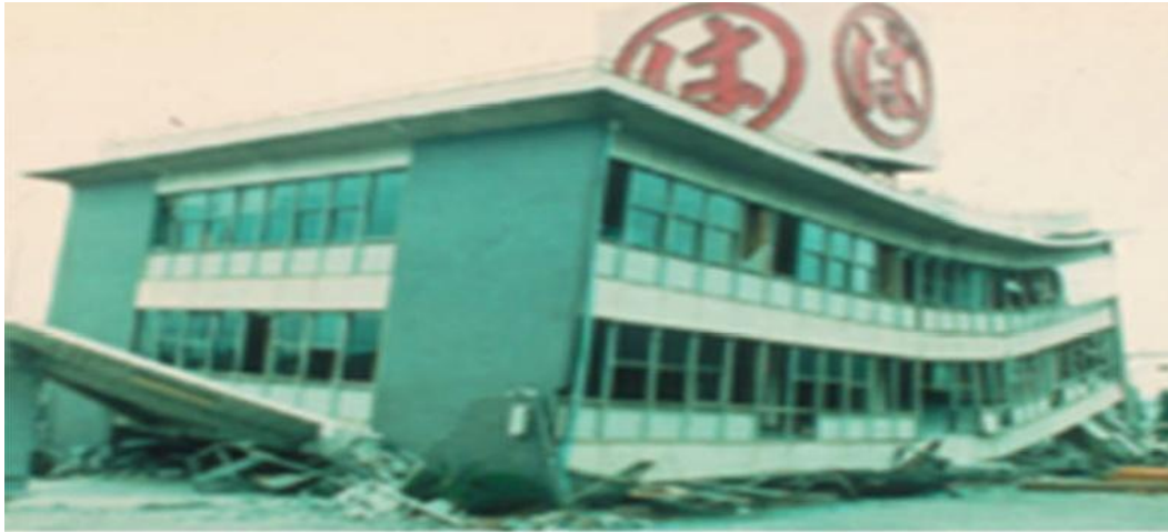
Figure II.22 : Rez-de-chaussée écrasé après la rupture des poteaux (séisme de Tokachi - Oki, Japon, 16.5.1968)[26].
