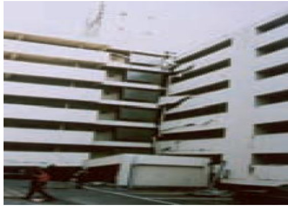
Figure II.15 : dommage du a l'irrégularité en plan (séisme de kobé japon 1995) [26].
