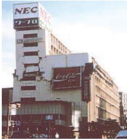
Figure II.29: dommage du a l'irrégularité en élévation (séisme de Kobe, japon 1995)[28].
