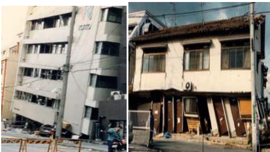
Figure II.28: étages flexibles au niveau du RDC (séisme de Kobe, japon 1995)[28].
