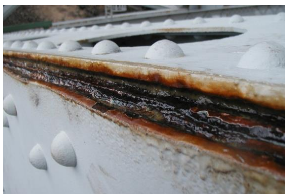
Figure II.22 : La corrosion par crevasses.
