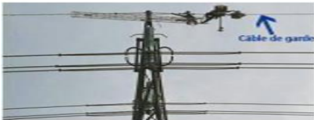
Figure (I.25) : Câble de garde. [10]
