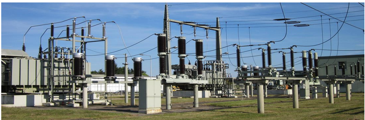
Figure (I.7) : Poste électrique HTA. [6]
