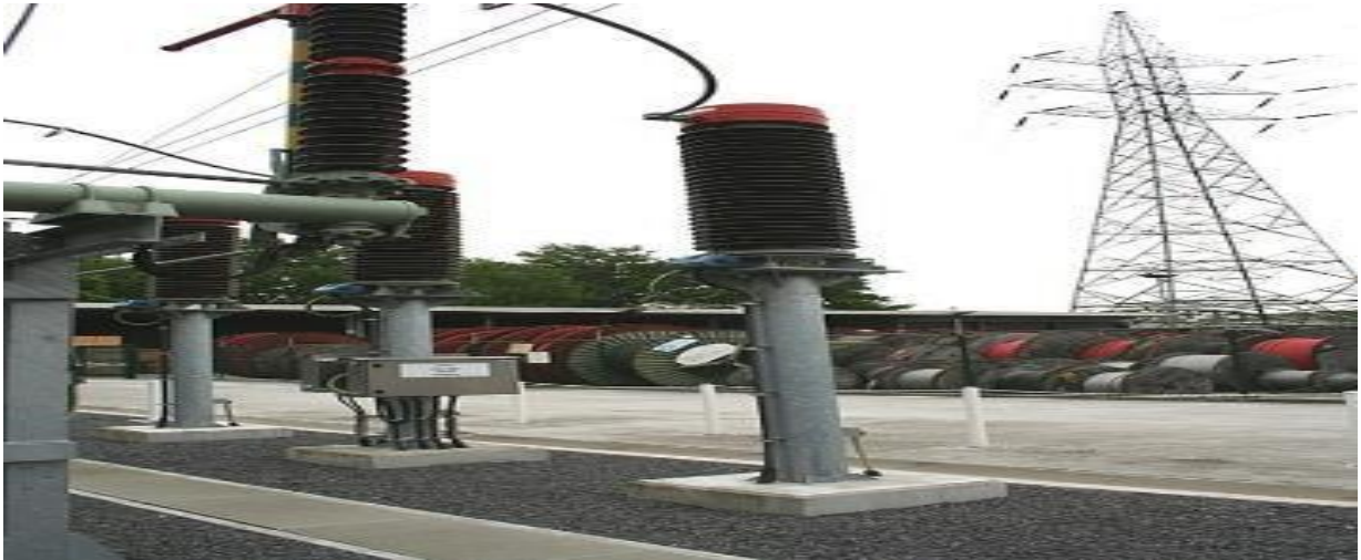
Figure (I-14) : Transformateur de tension. [7]
