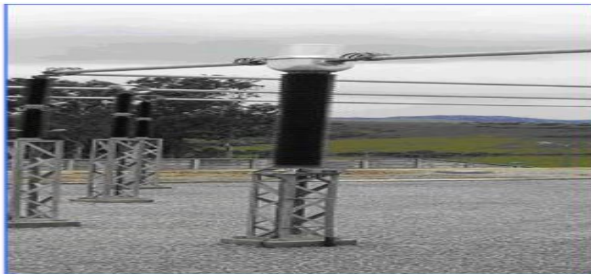
Figure (I-13) : Transformateur de courant. [7]
