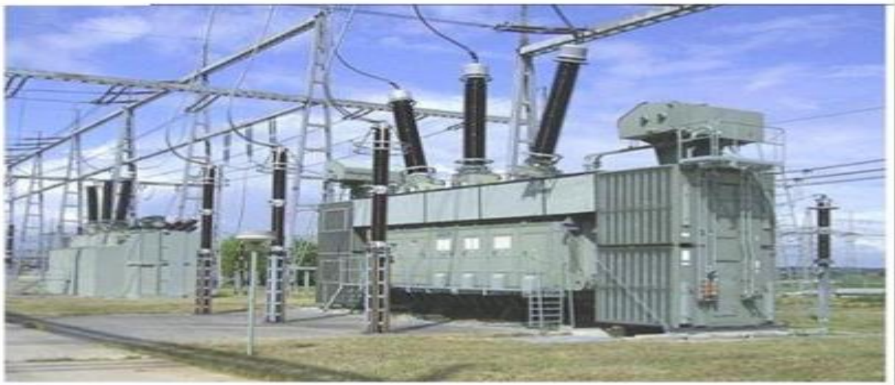
Figure (I.9) : Transformateur de puissance. [7]
