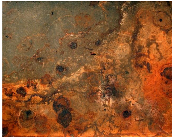
Figure I-6: Usure par corrosion
