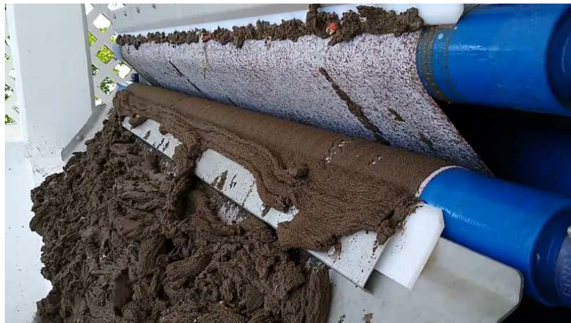
Figure II-08 : Déshydratation des boues [21]
