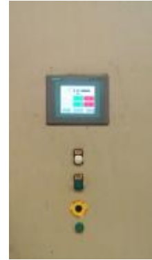
Fig (V-11) : la façade de l'armoire électrique
