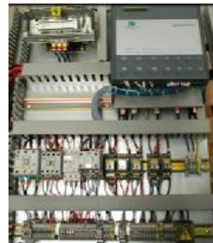
Fig (V-9) : la façade de l'armoire électrique de l'intérieur
