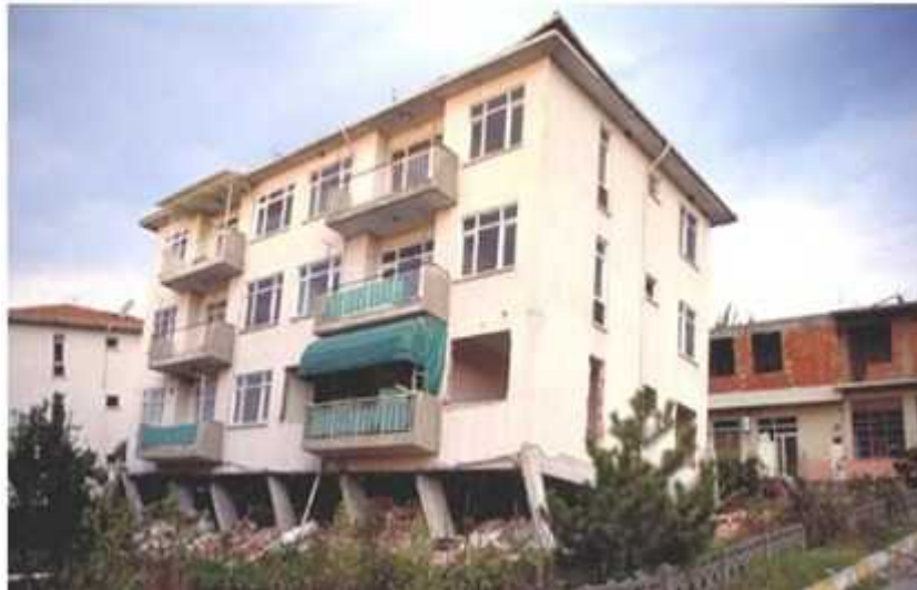
Figure I.14. Effondrement sous l'effet de tassements différents
