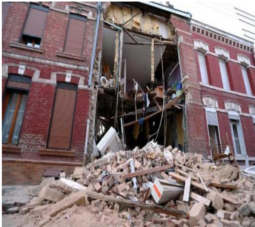
Figure 1.17: Dégâts d'un séisme
