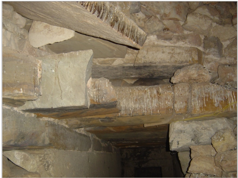
Figure18. Déjections de chauves souris sur le plafond du couloir d'accès aux chambres sépulcrales. Djeddars
