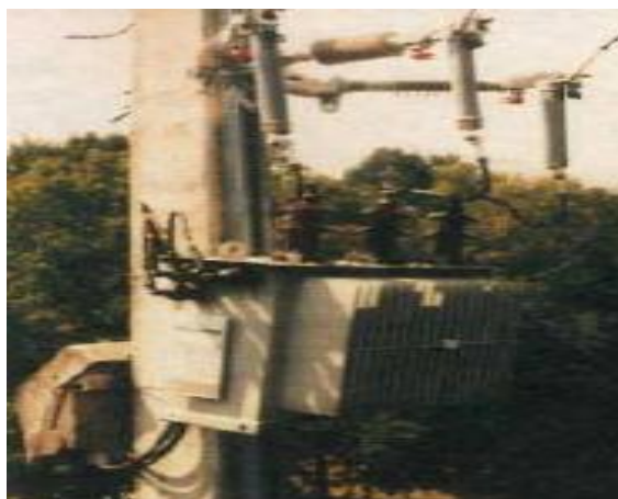
Figure (III.8) : Parafoudre HTA à Oxyde de Zinc et enveloppe synthétique protégeant un transformateur MT/BT.
