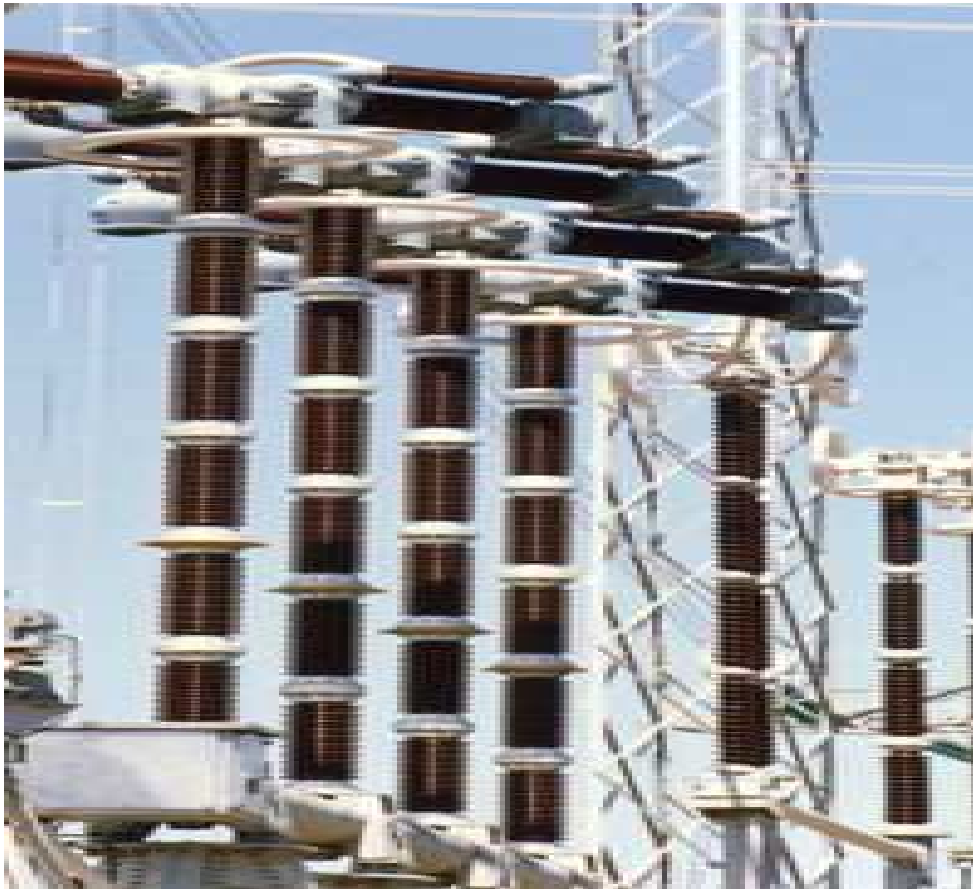
Figure. IV.14. disjoncteur à air comprimé
