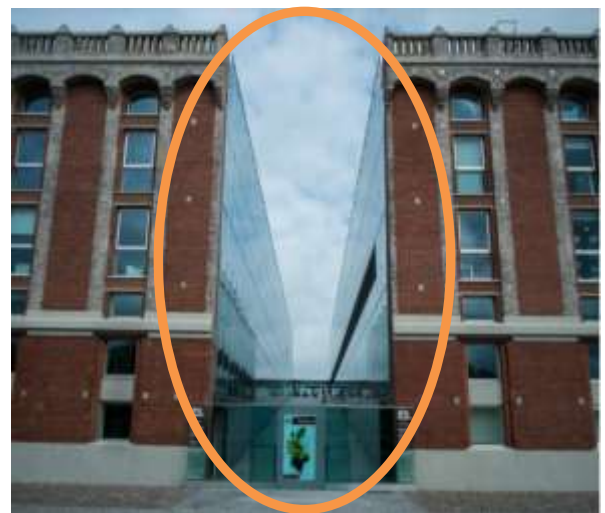
Figure 161 : faille traversant l'édifice Source : www.static.actu.fr
