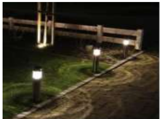
Figure 227 : Eclairage solaire pour jardin extérieur Source : www.objetsolaire.com
